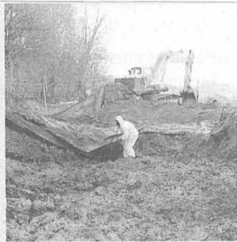
L'écoulement des eaux entre la décharge du Letten (ici lors de travaux au printemps dernier) et les captages de Schönenbuch ne semble pas affecter l'eau potable de la commune suisse. (Photo DNA - M.H.)
